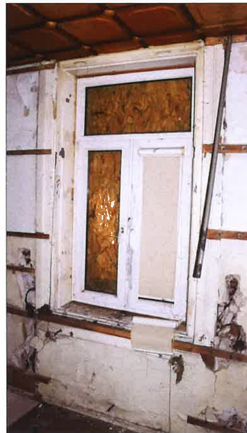
Okno zasłonięte od zewnątrz w pomieszczeniu po północno-wschodniej stronie budynku przy narożu północnym. (fot. Jakub Andrzejewski, 2020 r. )
