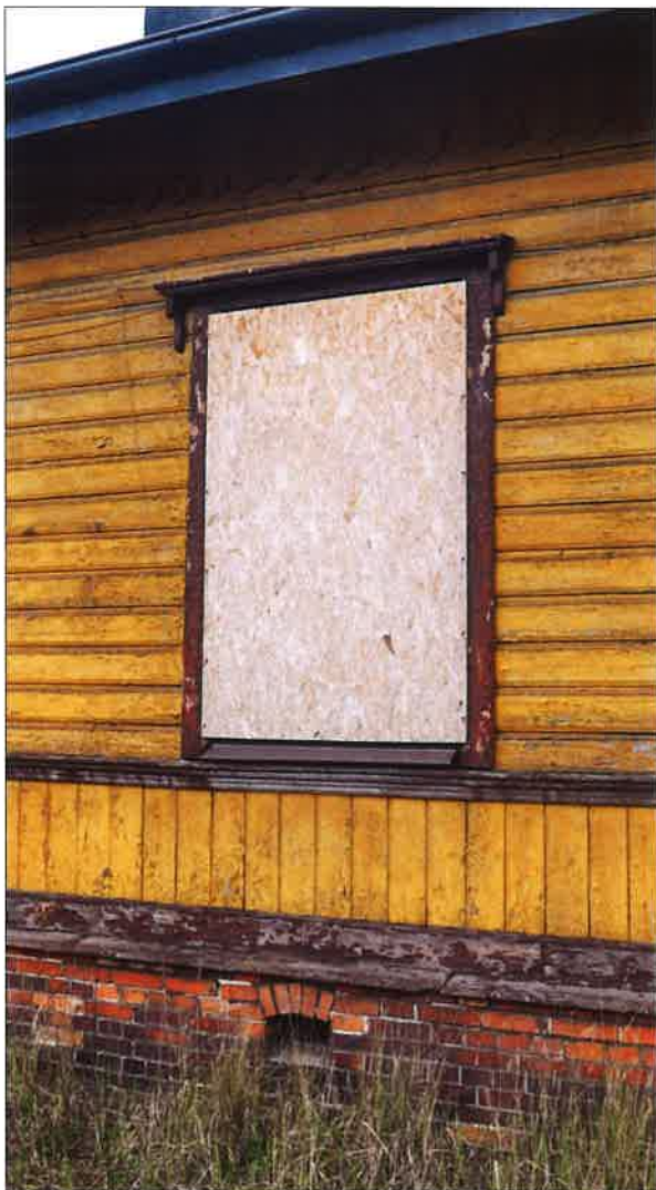
Okno wtórnie zastonięte płytą osb w elewacji południowo-wschodniej. (fot. Jakub Andrzejewski, 2020 r.)
