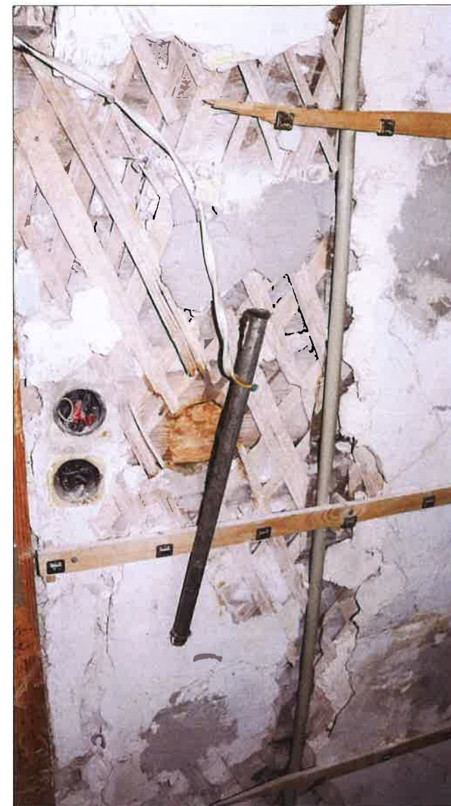
Podkonstrukcja pod tynkowanie ściany wykonana z drewnianych listewek. (fot. Jakub Andrzejewski, 2020 r.)
