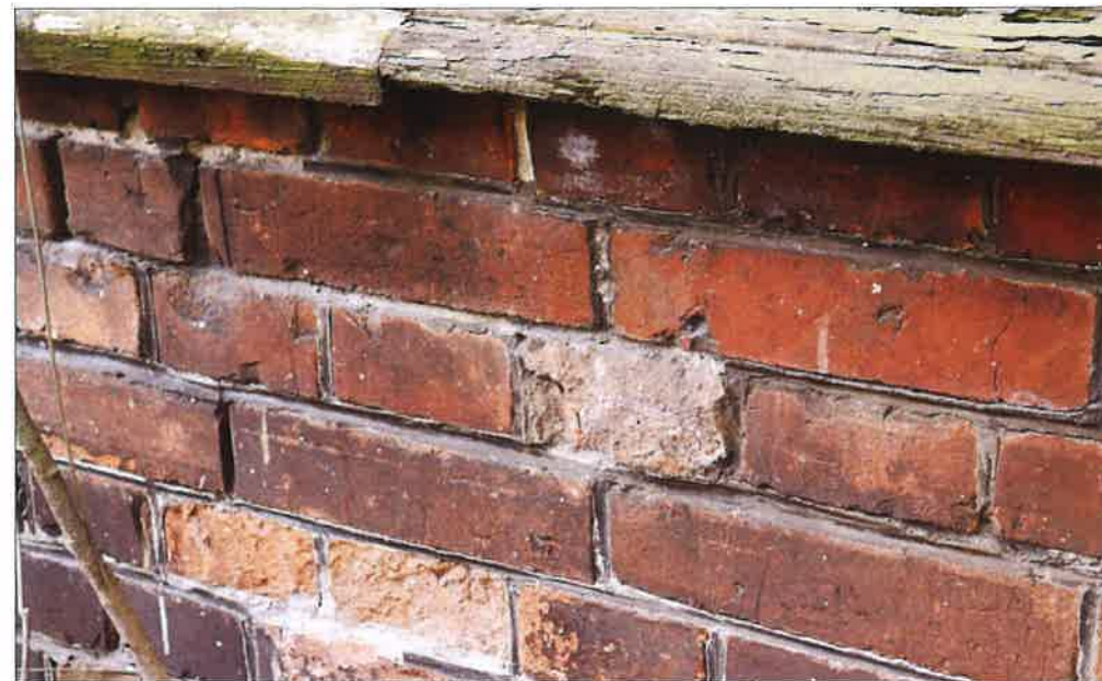
Mur ceglany przyziemia ułożony w wążku krzyżowym z widocznymi uszkodzeniami powierzchniowymi cegieł. (fot. Jakub Andrzejewski, 2020 r.)
