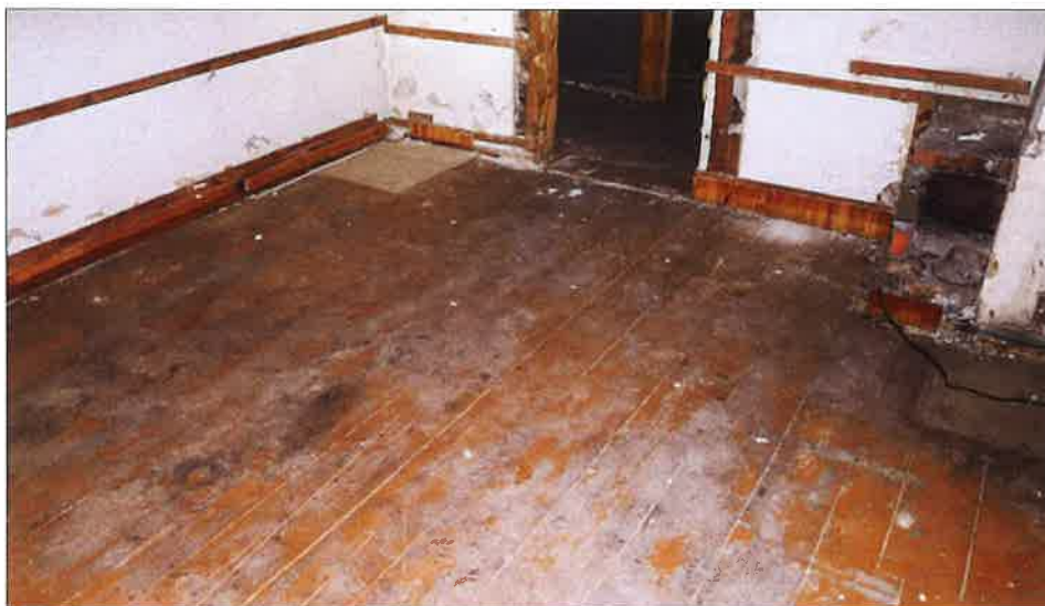
Najprawdopodobniej oryginalna podłoga w pomieszczeniu w zachodnim narożu budynku. (fot. Jakub Andrzejewski, 2020 r.)
