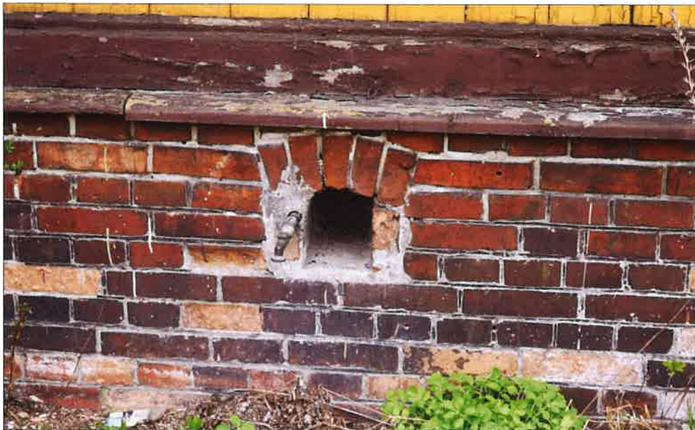
Kratka wentylacyjna w ceglany murze ściany przyziemia, w eleacji północno-wschodniej. (fot. Jakub Andrzejewski, 2020 r.)
