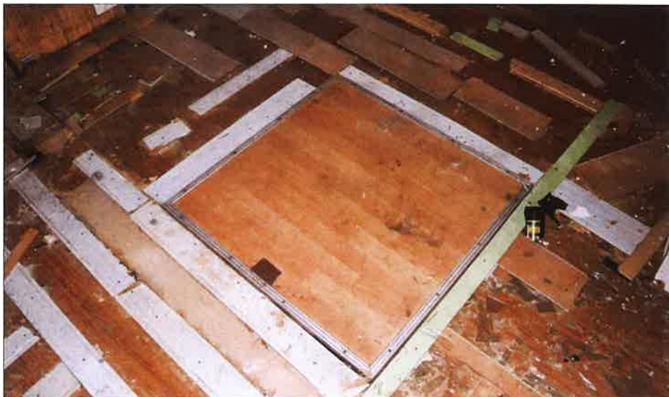
Wtórnie wykonane wejście do pomieszczenia piwnicy pod podłogą w północnym narożu budynku. (fot. Jakub Andrzejewski, 2020 r.)
