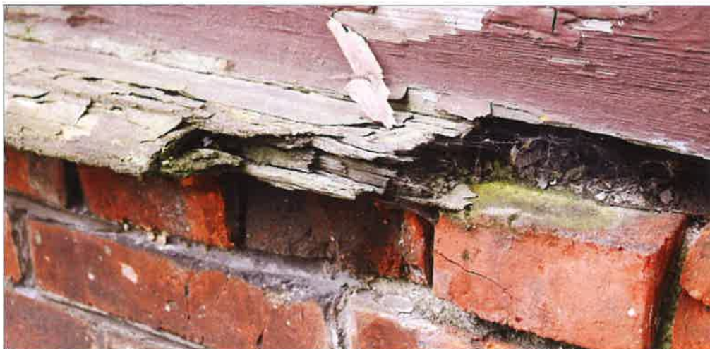
Uszkodzona deska - okapnik powyżej ceglany muru. (fot. Jakub Andrzejewski, 2020 r.)
