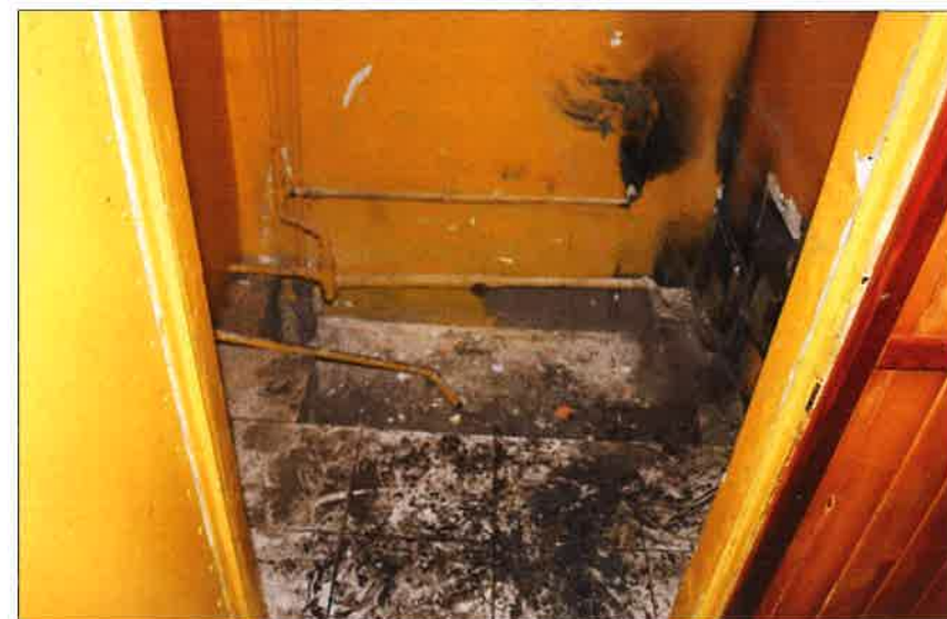
Pomieszczenie kotłowni przy korytarzu wejściowym po północno-zachodniej stronie budynku. (fot. Jakub Andrzejewski, 2020 r.)
